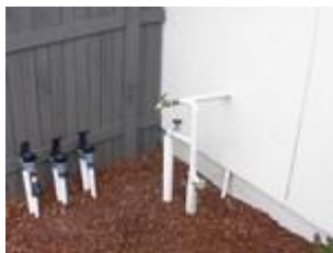
Foto 1 - Un grifo para manguera y tubos
